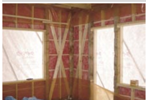
室内から見た付加断熱材施工の様子。耐震性を高めるために筋交いはすべて入れ替えており、胴差・土台回りには後張りの防湿気密シートも施工
